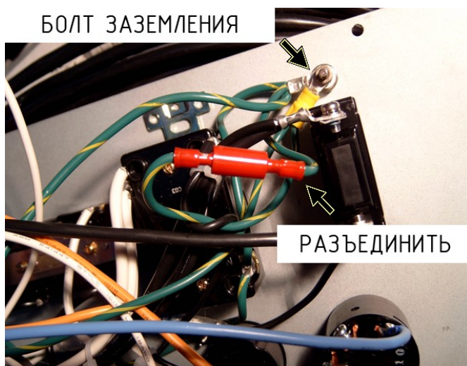
Рис.П2.10. Вид на болт заземления в генераторной станции Yamaha EF12000E.
